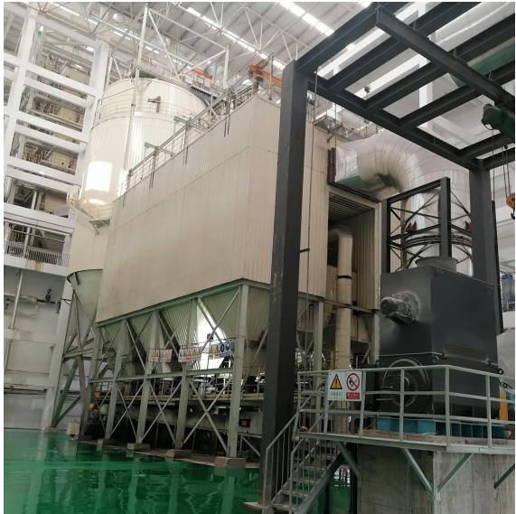
焚烧烟气净化系统
